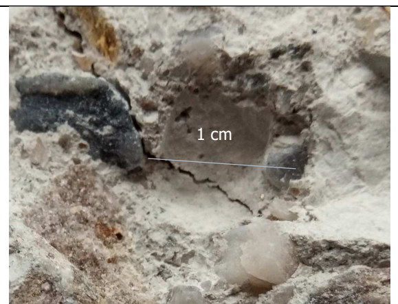
Figure 6: échantillon 1179-I détail à la loupe binoculaire du rectangle ci-contre. La fissure contourne le grain de sable et tapisse l'empreinte.
