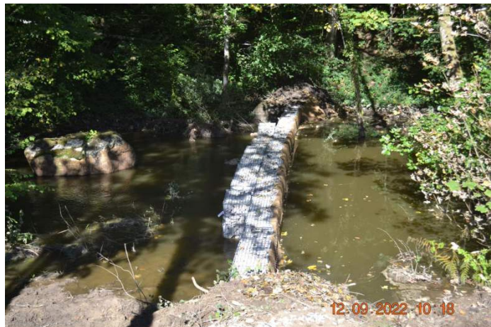
Photographie 4 : Dispositif de barrage filtrant mis en œuvre dans le cadre de la vidange du barrage des Settons (maîtrise d'œuvre ISL-EGIS)
